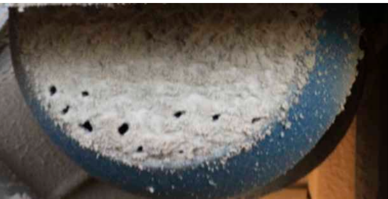
FIGURA 2: Rejilla de protección obstruida por polvo.
